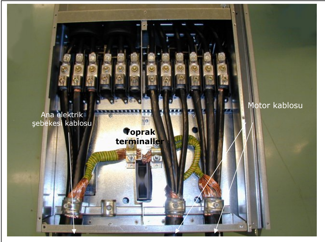
Şekil 6-17. Vacon NX, FR9'de kablo kurulumu
