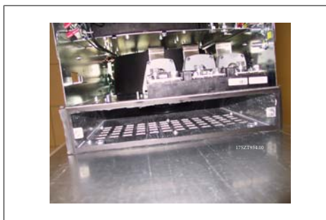
Ilustración 3.33: Adaptador de la conducción inferior instalado
