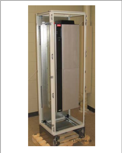
Ilustración 3.36: Convertidor de frecuencia instalado en el armario
