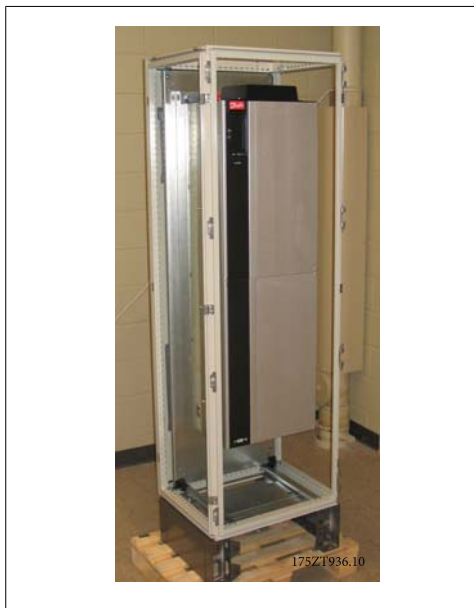
Ilustração 3.36: Conversor de frequência instalado em cabine
