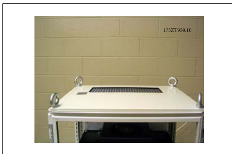
Abbildung 3.50: Sicht auf Rittal-Schaltschrank von oben
