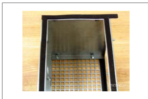
Afbeelding 3.43: Pakking aangebracht aan weerszijden van de beugel van de frequentieomvormer en de bovenafdekking van het luchtkanaal met ventilatierooster.
