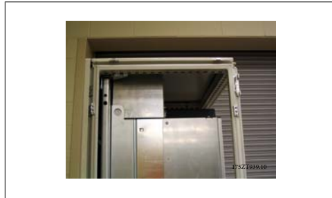
그림 3.38: 상단 덕트와 외함 상단 설치된 모습
