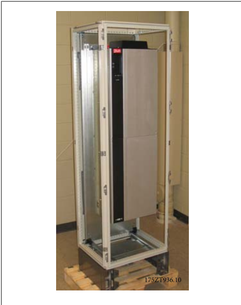
그림 3.36: 외함에 설치된 주파수 변환기
