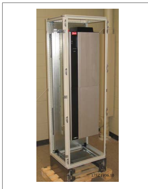
Illustration 3.36: Variateur de fréquence installé dans un boîtier métallique
