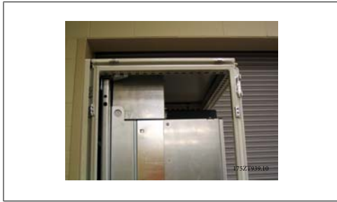
그림 3.38: 상단 덕트와 외함 상단 설치된 모습
