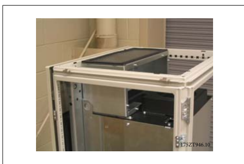
图 3.46: 安装好的顶部风道
